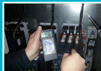
Messung der Temperaturen des Leitermaterials bei el. Belastung
