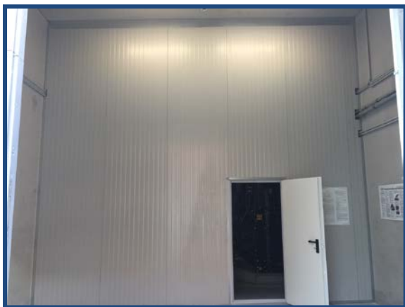
Projekt Lidl Wundschuh 2300kVA Schalldämmwand
