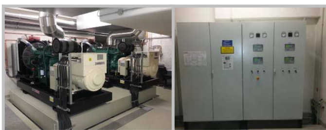
Nach dem Umbau mit modernster Steuerung Netz- und Inselfparallelbetrieb. Betrieb mit 2 Netzeinspeisungen
