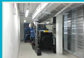
Projekt ADAC München Notstromanlage 1750kVA Auf engsten Raum verbaut
