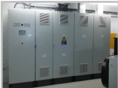
Die fertige Schaltanlage nach Inbetriebnahme Projekt ADAC München 1x 2100kVA
