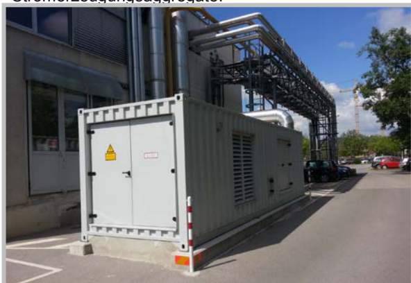
Notstrom 800kVA mit 3 Netzeinspeisungen Projekt Rechenzentrum Drei Hutchison/Wien
