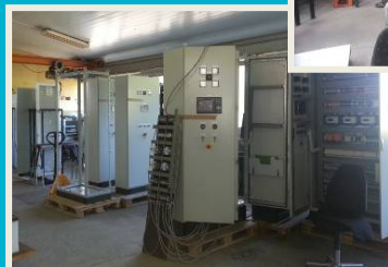
Schaltanlage für 4 Netzein- speisungen mit Prüfaufbau
