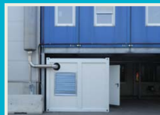
NÖM Baden 275kVA Containeraggregat Ei 90 Bauweise gem. Vorgaben NÖLRG
