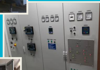
Proj. UKH Murnau Steuerteil Notstromanlage 900 kVA mit zwei Netzeinspeisungen u. zusätzlicher Handsynchronisierung
